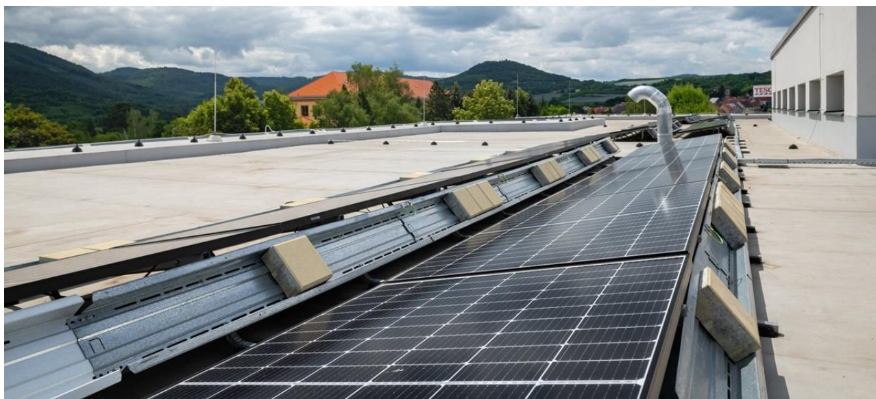
Střešní fotovoltaická elektrárna
