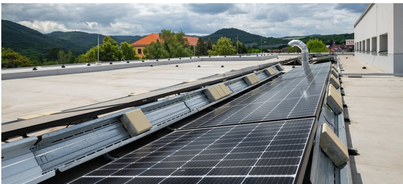
Obr. 63: Střešní fotovoltaická elektrárna
